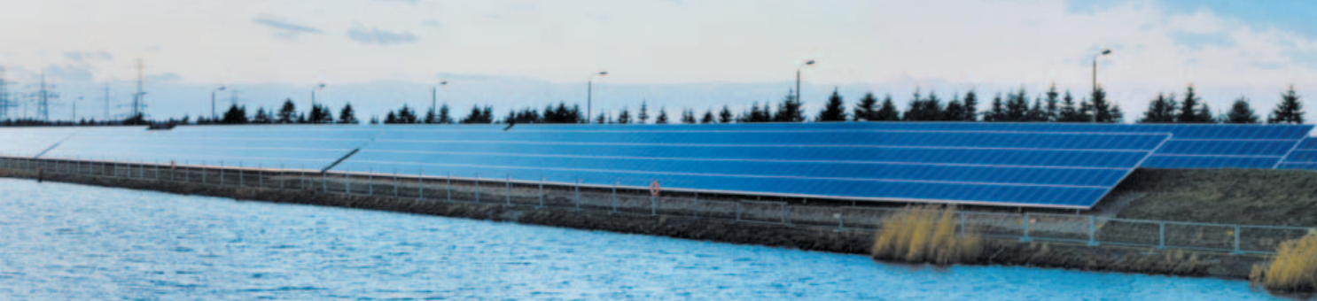
Das neue Solarkraftwerk in Lubmin auf dem Gelände des stillgelegten Kernkraftwerks.
