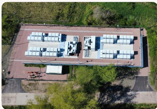
Großbatteriespeicher Halle (Sachsen-Anhalt)
